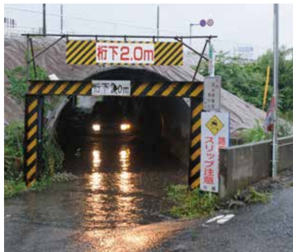
▲冠水したアンダーパス
